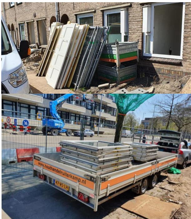
Een deel van de materialen uit bouwblok 1 van de Omloop wordt hergebruikt.
